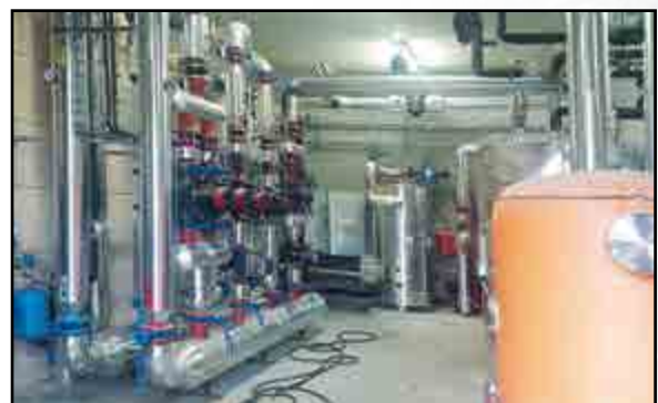
Machinerie piscine de l'Arbresle
