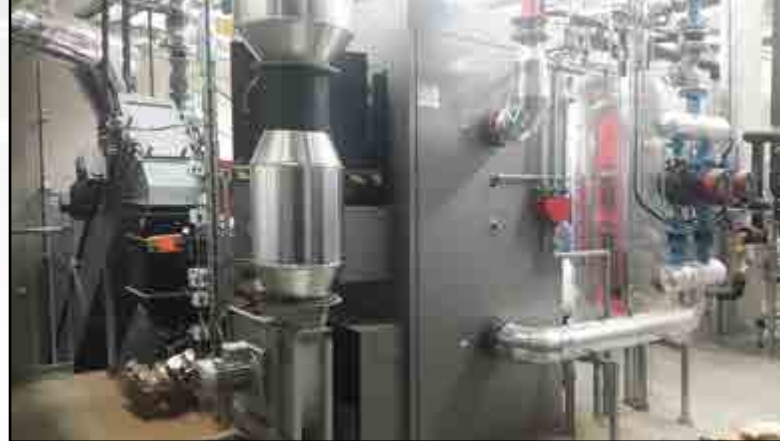
Contrôle du système de ventilation d'air de l'établissement
