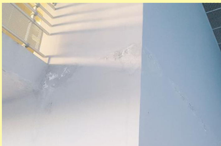
Infiltrations et fissures causées par une étanchéité défectueuse du sol des douches situées au premier étage de l'établissement.
